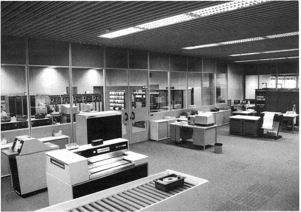
Abb. 3: Cyper 174 im Neubau des Hochschulrechenzentrums.
